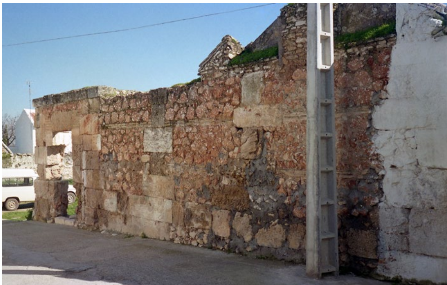
Figura 3. Lora de Estepa. Restos de una fachada lateral.
